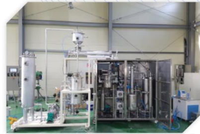
탄소핵종 회수 재활용 설비
